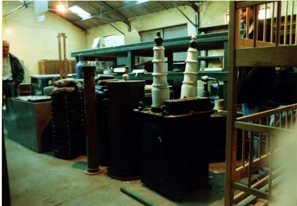
Foto Nr. 8: Lagerhalle am Institut Balseiro-Bariloche ganz links: Mario Della Janna, ebenso abgebildet einer der beiden Extralagen-Kondensatoren, ein Kondensator der Bank sowie der zugehörige HV-Transformator
