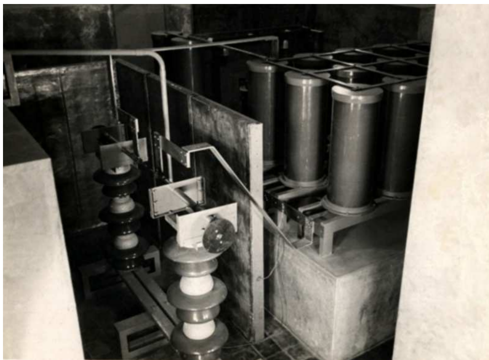
Foto Nr. 5: Das vordere Ende der Kondensatorbatterie
